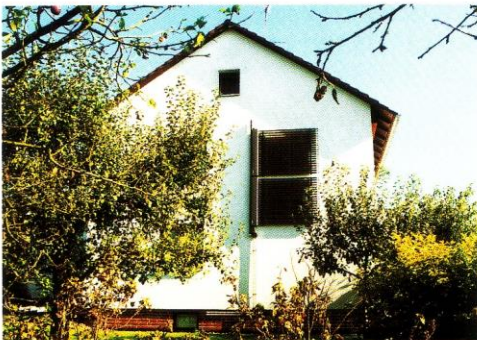
Bild 4: Thermische Solaranlage – Röhrenkollektoren an senkrechter Hauswand, Ortsteil Vahle
