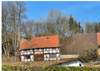
Marode Gebäudesubstanz, Delliehausen
